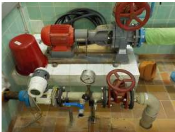
Abbildung 6-3: Zulaufmessung TB Bohrung 1
