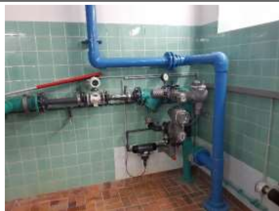
Abbildung 6-4: Zulauf der ehemaligen Bachfassung - Außer Betrieb
